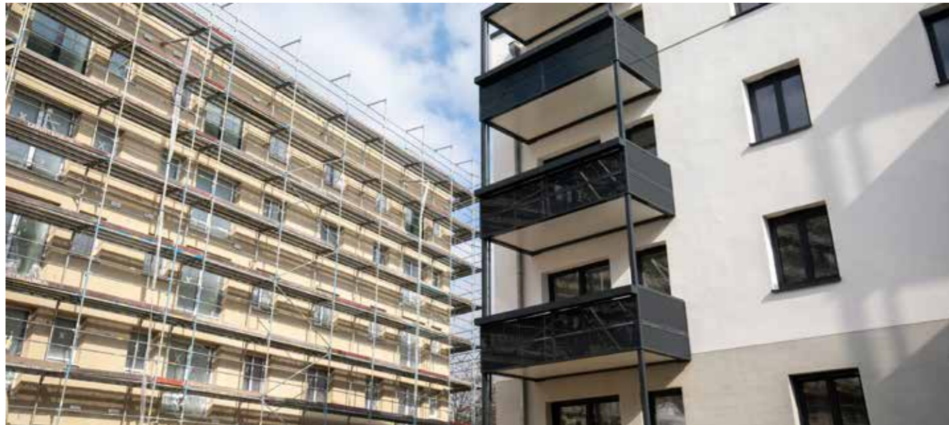
In der Gaußstraße in Leutzsch steht ein LWB Projekt in serieller Bauweise kurz vor der Fertigstellung. Der Aufsichtsrat gab nun grünes Licht für weitere Bauvorhaben dieser Art.
